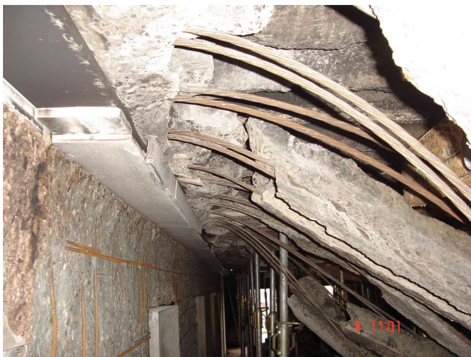
Foto: een bezweken betonconstructie door brand
