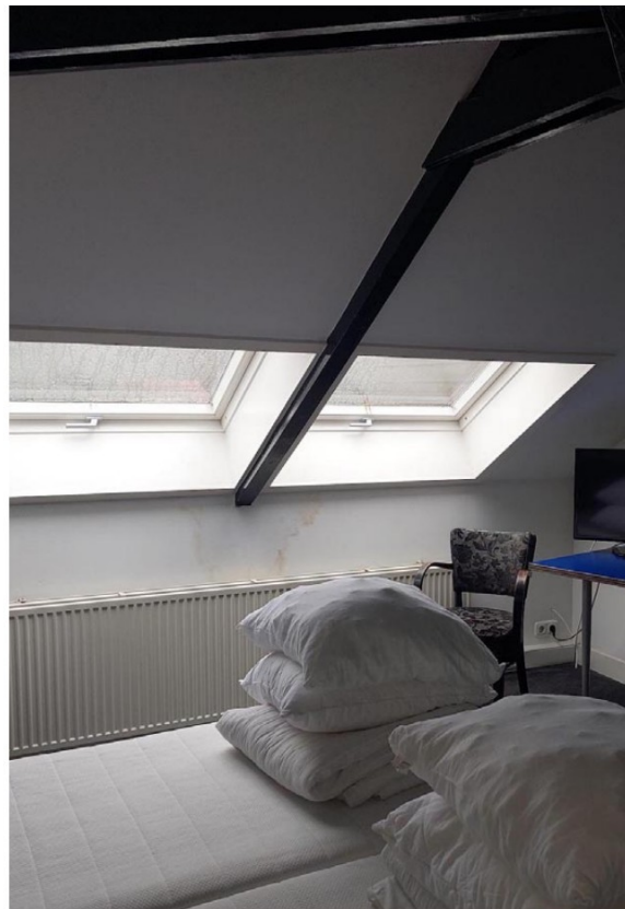
Afb. 3.4: Knieschotten vanaf de binnenzijde gezien, afgetimmerd, hier met een waterschade vanuit een lekkende constructie bij de dakramen. Foto: [redacted] 22 november 2024.
