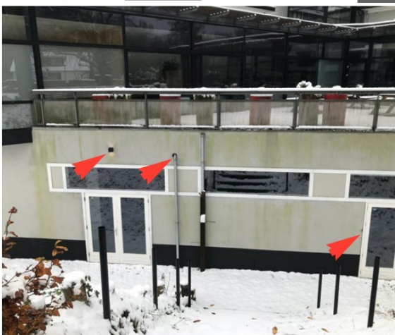
Afb. 2.2: Kelderverdieping, zonder toegangen/openingen in de gevel, zonder spouw en met vochtschade.
