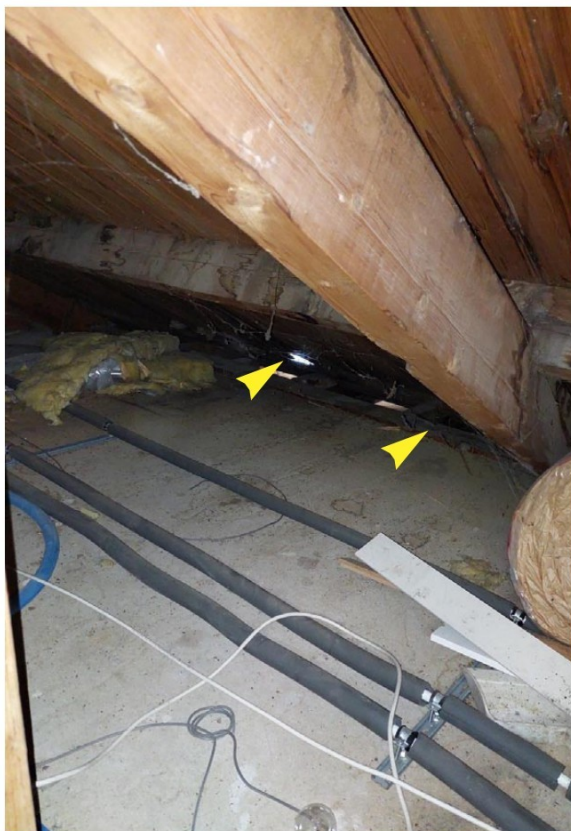
Afb. 3.3: Huidige situatie achter het knieshot, met kabels en leidingen en losliggende isolatierollen. Halverwege de foto is enigszins verdiept de spouwmuur zichtbaar. Een rotte plek in het dakbeschoot geeft van buitenaf toegang tot de ruimte. Foto: [redacted] 22 november 2024.
