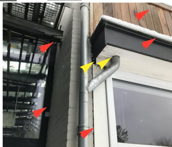
Afb. 2.3: Begaande grond met toegangen bij dakoverstekken en bij hemelwaterdoorvoeren. Kozijnen en betimmering zonder kieren of open delen.
