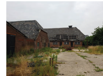
Links een deel van de melkveestal, daarnaast de oude schuur en op de achtergrond het achterhuis van de boerderij met stormschade.
