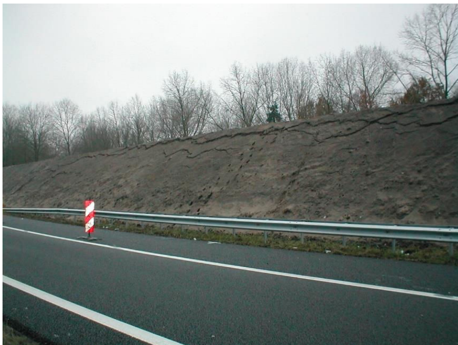
Figuur 10: voorbeeld instabiliteit bij geluidswal
