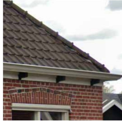
Geprofileerde goten met gootklossen
