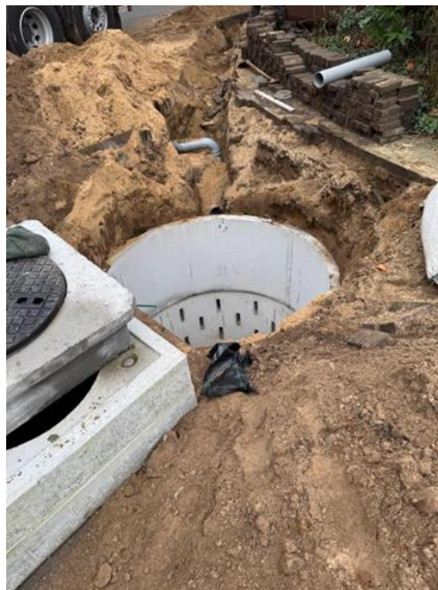
Infiltratieput voor hemelwater Vivaldipark
