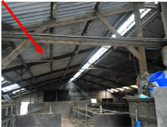
Foto 16 | Golfplaten op het dak
