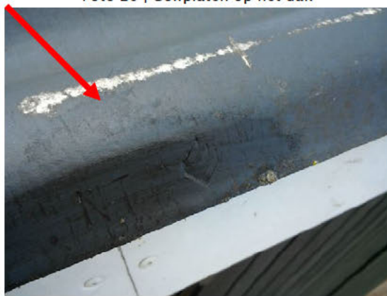
Foto 27 | Golfplaten op het dak
