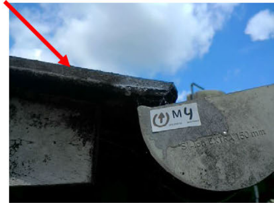
Foto 17 | Golfplaten op het dak
