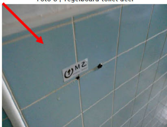
Foto 10 | Tegelboard toilet deel
