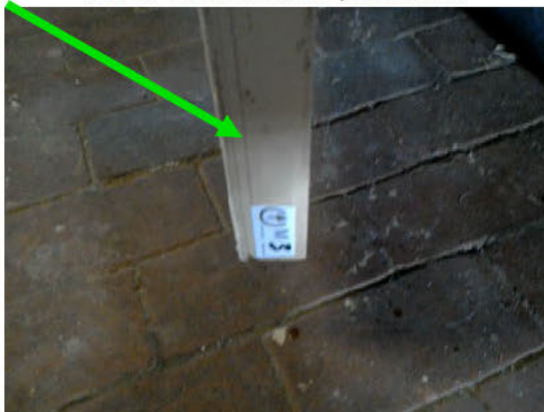
Foto 13 | brandwerende plaat in deur
