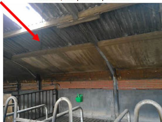
Foto 26 | Golfplaten op het dak
