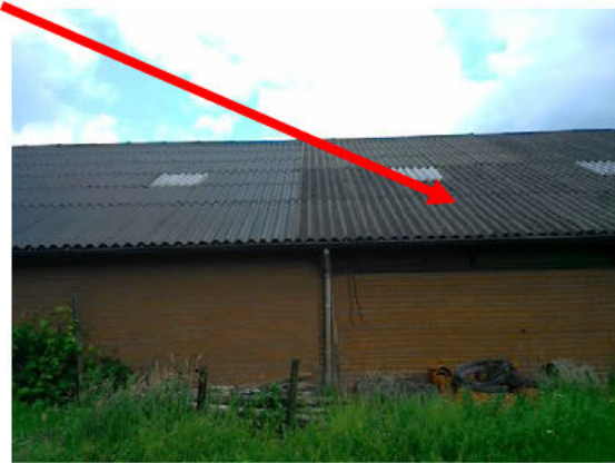
Foto 24 | Golfplaten op het dak
