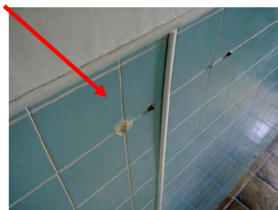
Foto 9 | Tegelboard toilet deel
