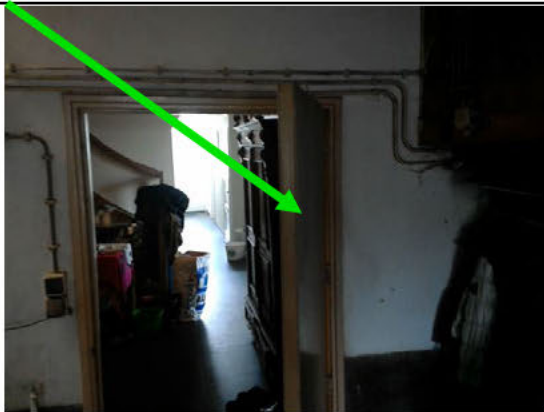
Foto 11 | brandwerende plaat in deur
