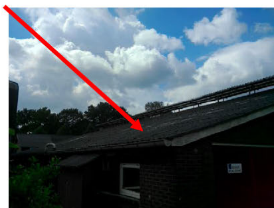
Foto 15 | Golfplaten op het dak
