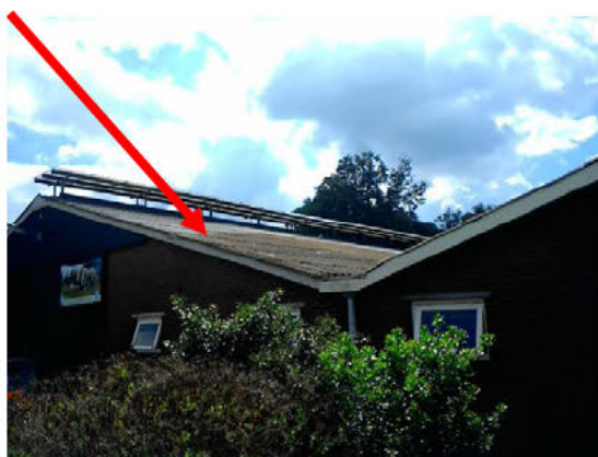
Foto 14 | Golfplaten op het dak
