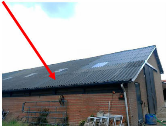
Foto 23 | Golfplaten op het dak
