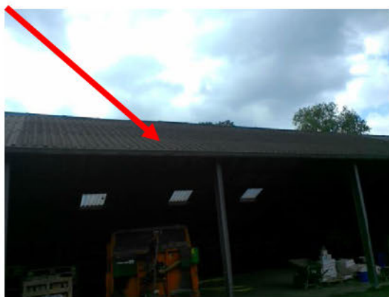
Foto 21 | Golfplaten op het dak
