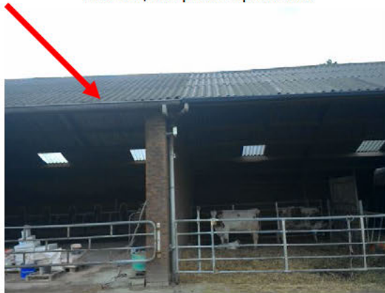
Foto 25 | Golfplaten op het dak
