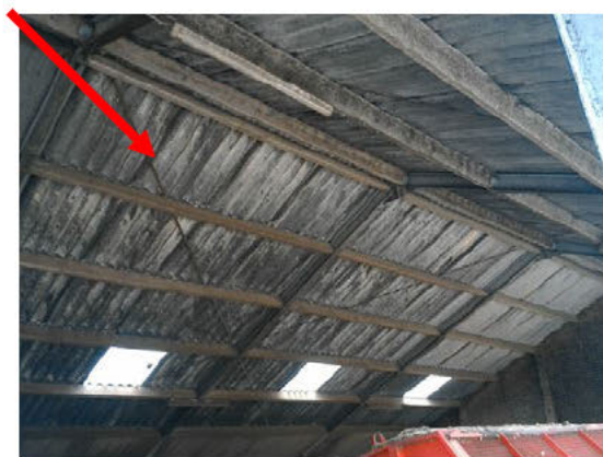
Foto 22 | Golfplaten op het dak
