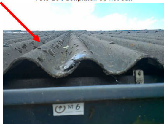
Foto 28 | Golfplaten op het dak
