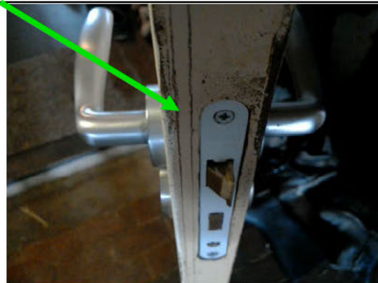
Foto 12 | brandwerende plaat in deur
