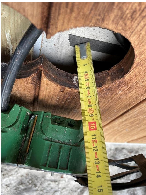
Afbeelding 3. Weergave ruimte tussen vezelcementplaat en houten gevelbetimmering. De foto is gemaakt bij een stopcontact wegens makkelijk bereik. De openingen in de gevel krijgen een andere vorm en hoogte.
