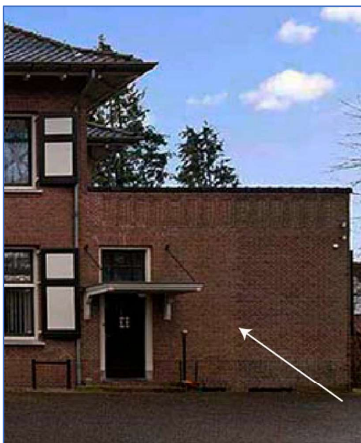
Verkleuring van het metselwerk door eerdere uitbreiding, hier sluit het tussenlid aan op de villa.
