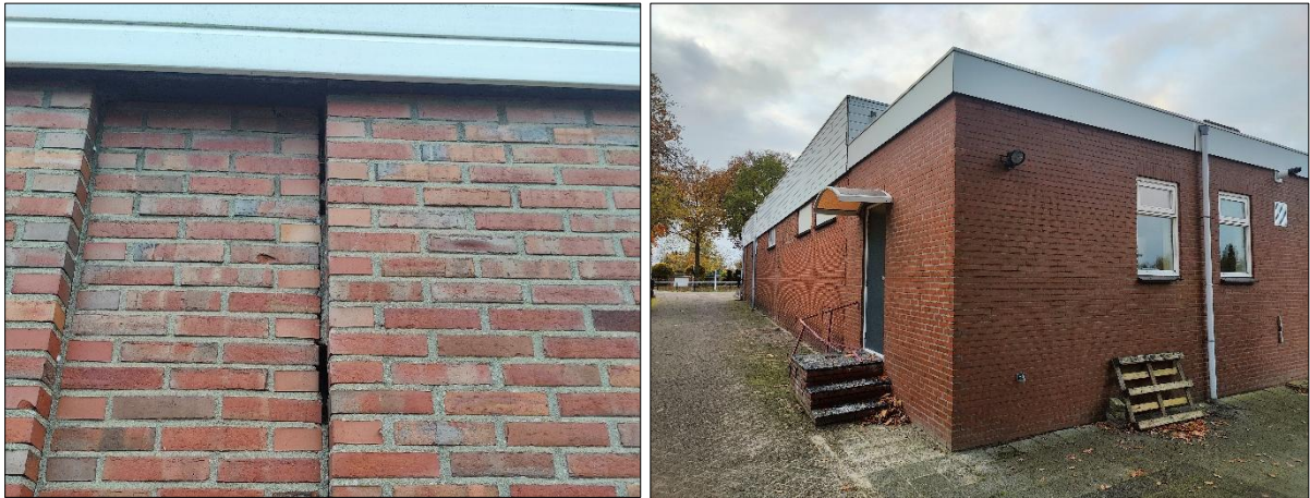
Foto links: gaten en kieren in de gevel. Foto rechts: vleermuizen kunnen in ruimte tussen boeiboord en gevel kruipen.
