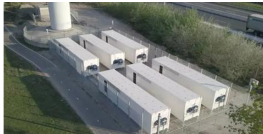
Figuur 2.4: Voorbeeld vormgeving batterij in zeecontainer (Bron: Greenchoice, 2025)
