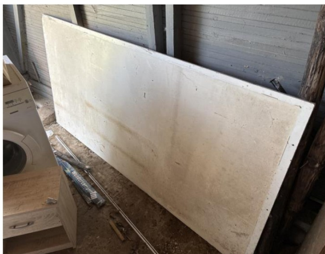
Asbestvrij plaatmateriaal begane grond schuur 1
