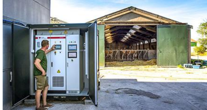
Figuur 2.3: Bedrijfsbatterij op agrarisch erf (Bron: Boerenbond.nl)
