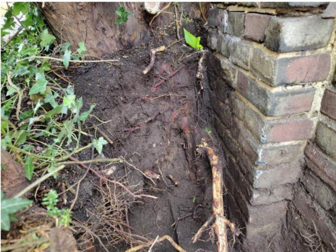
Wortelgroei aan linker achterzijde van bank (gezien vanaf voorzijde).
