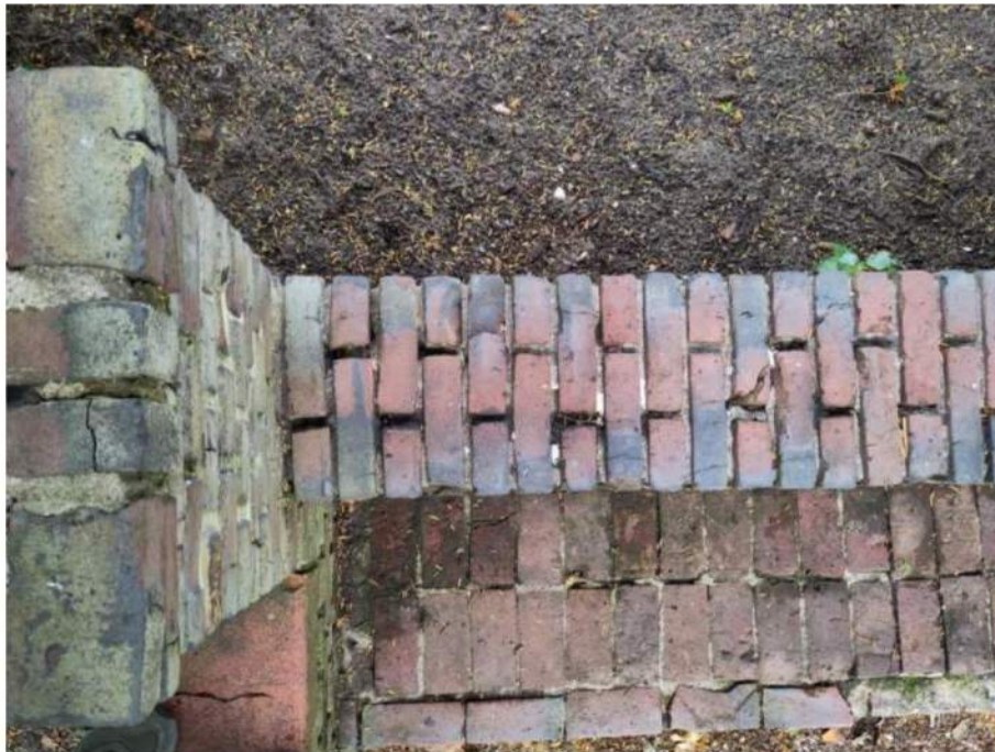
ZW (13): breuken in het metselwerk in het horizontale vlak van de rugleuning.
