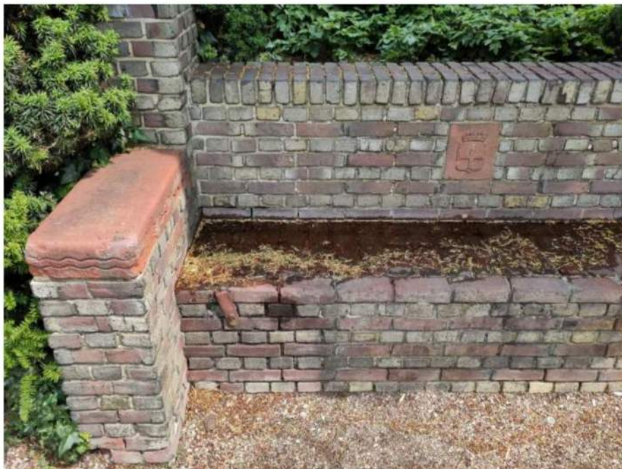
NO (5): stilstaand water op de zitting van de bank wat niet weg kan vloeien.
