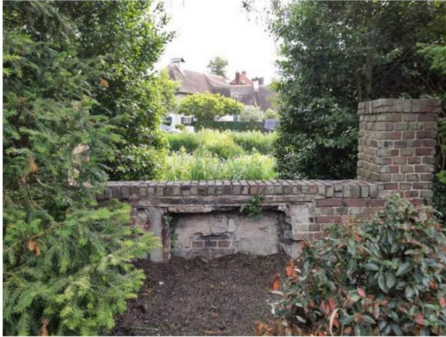
ZW (17): sparing aan de achterzijde van de bank, mogelijk ten behoeve van de pompinstallatie.
