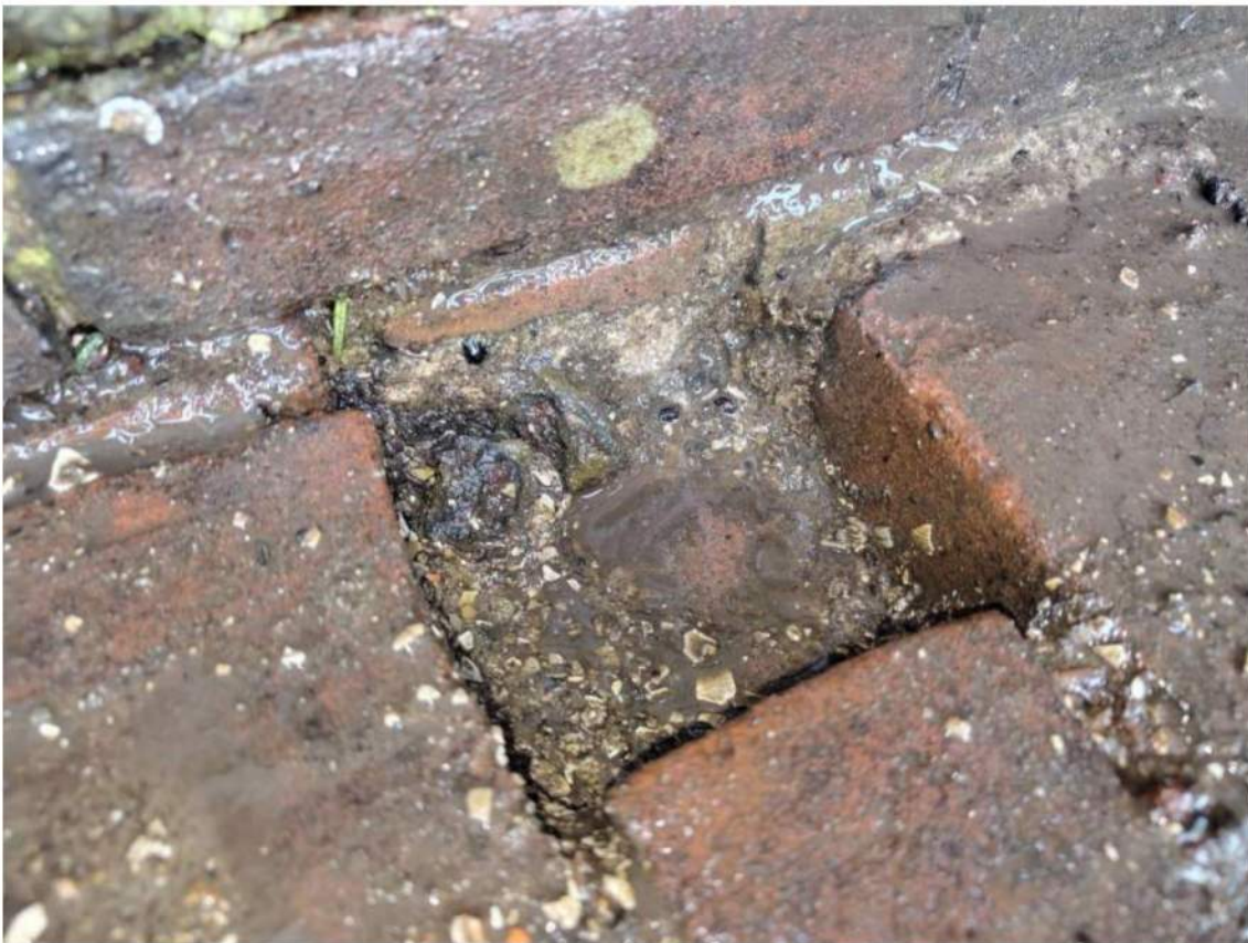
Verwijderde baksteen in zitting met holle buis naar achterzijde van bank.
