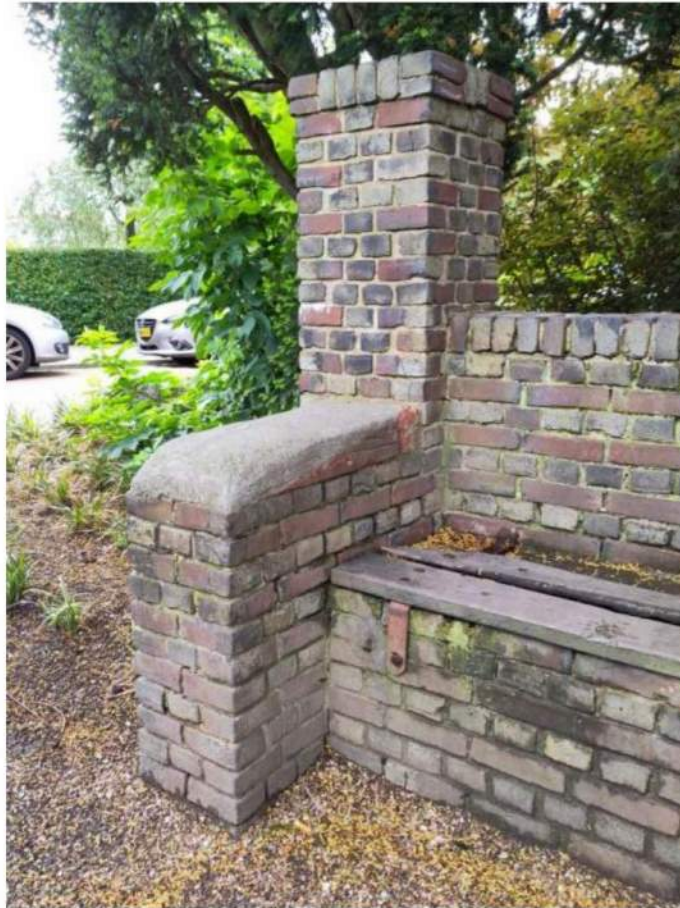
ZO (5): arMLEuning in afwijkende kleur en materiaal met ernstige slijtage en cohesieverlies.
