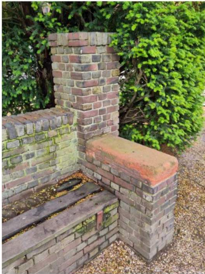
ZO (10): armleuning met eerder uitgevoerde mortelreparaties.
