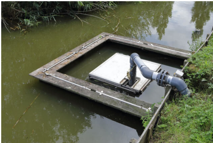
Figuur 2 Voorbeeld inlaat Aquathermie Koppert Cress in Monster.
