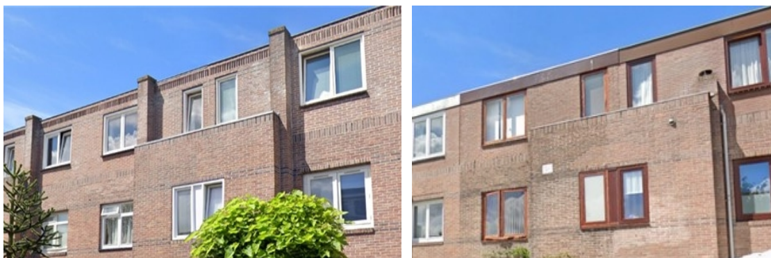
De dakbeëindiging op de foto links is zorgvuldig doorgezet in de nieuwe gevel en als trend doorgezet in de aangrenzende dakopbouwen. Op de foto rechts uit dezelfde straat ontbreekt een zorgvuldige gevelbeëindiging met een matige uitstraling van de dakopbouw op het straatbeeld als gevolg.
