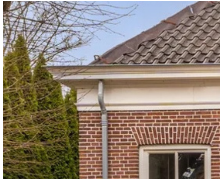
Bakgoot met klassieke profilering, direct op het metselwerk geplaatst zonder overstek (dak blijft binnen de gevellijn)
