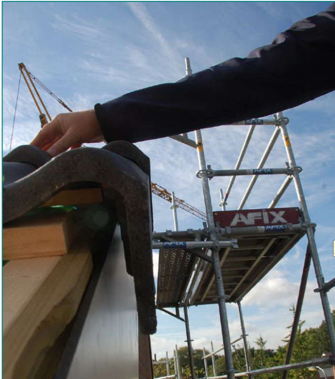
Figuur 10: afstand van 3 cm tussen boeibord en gevelpan. Hierdoor ontstaat een invliegopening en toegang tot de ruimte onder de dakpannen voor gierzwaluw en vleermuizen.
