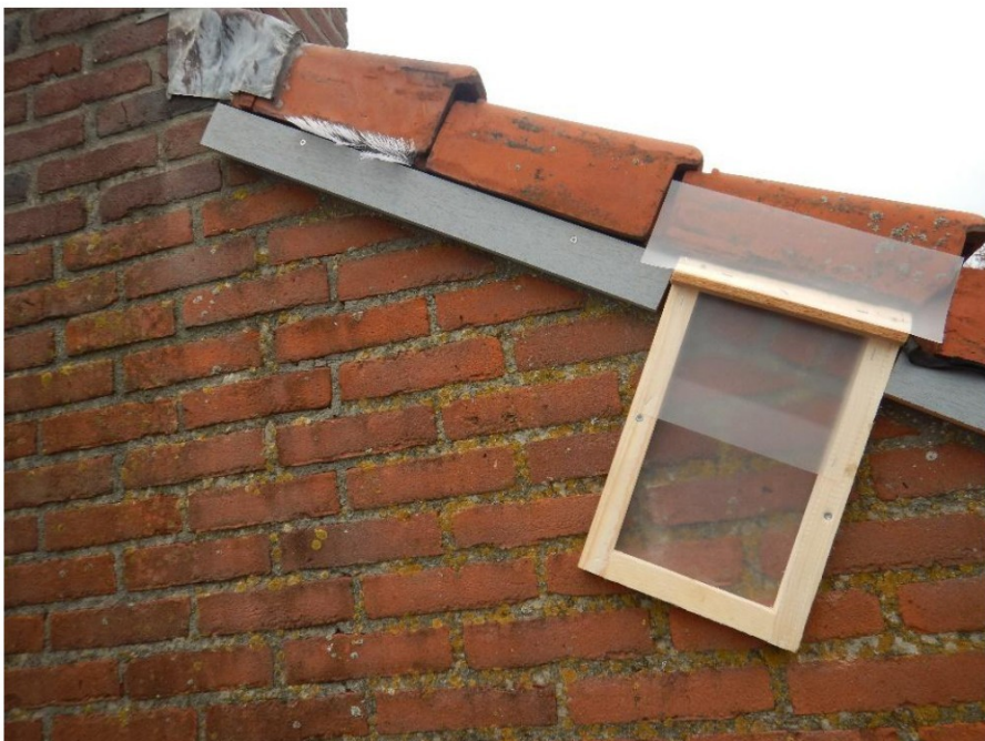
Detail exclusion flap met dichtzetten gevelpan in combinatie met gootborstels en compriband.
