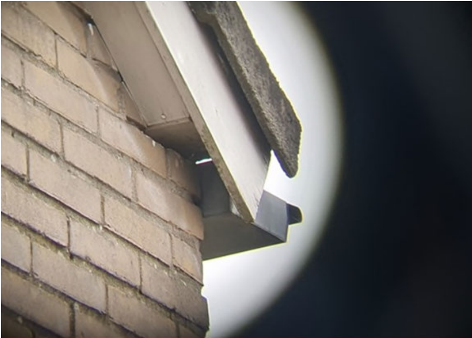
11: Ruimte onder het overstek bij de dakgoot, mogelijk bied dit toegang tot een geschikte nestplaats.
