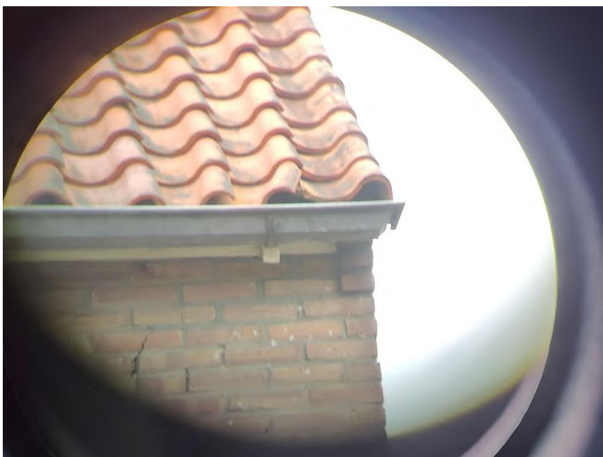
Foto 14: verschoven pannen in de goot.
