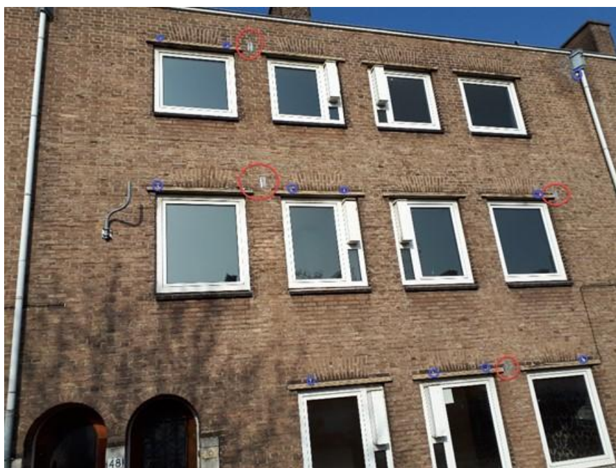
Detail exclusion flap (rood) en afdichten open stootvoegen. Tijdens het ongeschikt maken worden alle stootvoegen beoordeeld. Doorlopende open stootvoegen worden afgedicht met exclusion flaps en rugvulling of spouwmuurborstels.
