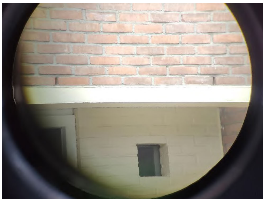
Foto 15: Open stootvoegen in gevel.
