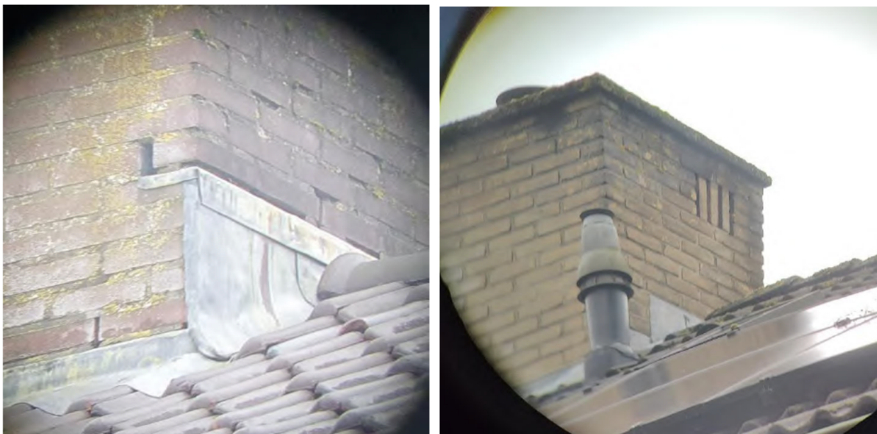
Foto 13: Ruimte bij voegen/lood en grote ventilatievoegen in schoorstenen
