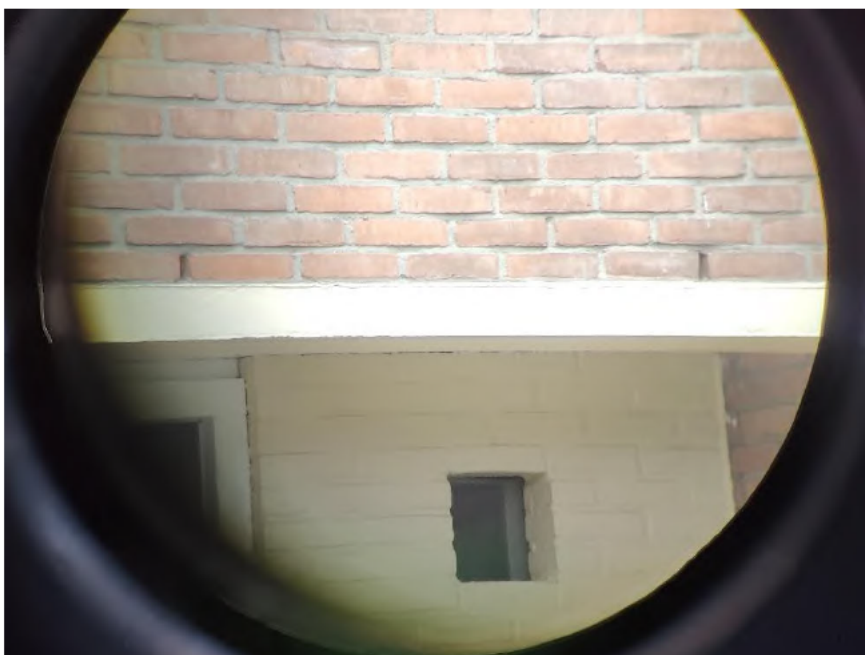
Foto 15: Open stootvoegen in gevel.
