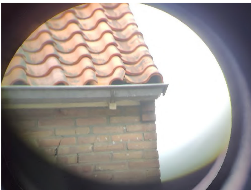
Foto 14: verschoven pannen in de goot.
