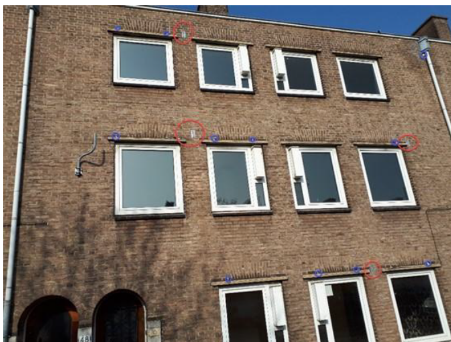
Detail exclusion flap (rood) en afdichten open stootvoegen. Tijdens het ongeschikt maken worden alle stootvoegen beoordeeld. Doorlopende open stootvoegen worden afdicht met exclusion flaps en rugvulling of spouwmuurborstels.
