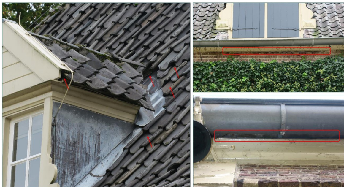
Figuur 3.1 Er zijn verschillende openingen en kieren aanwezig welke toegang bieden tot de open dakruimte, waaronder scheefliggende dakpannen, kieren tussen de gootbekisting en onder de dakgoot.
