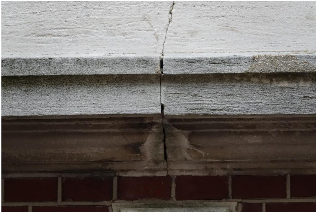
Figuur 11 Scheuren in voeg
