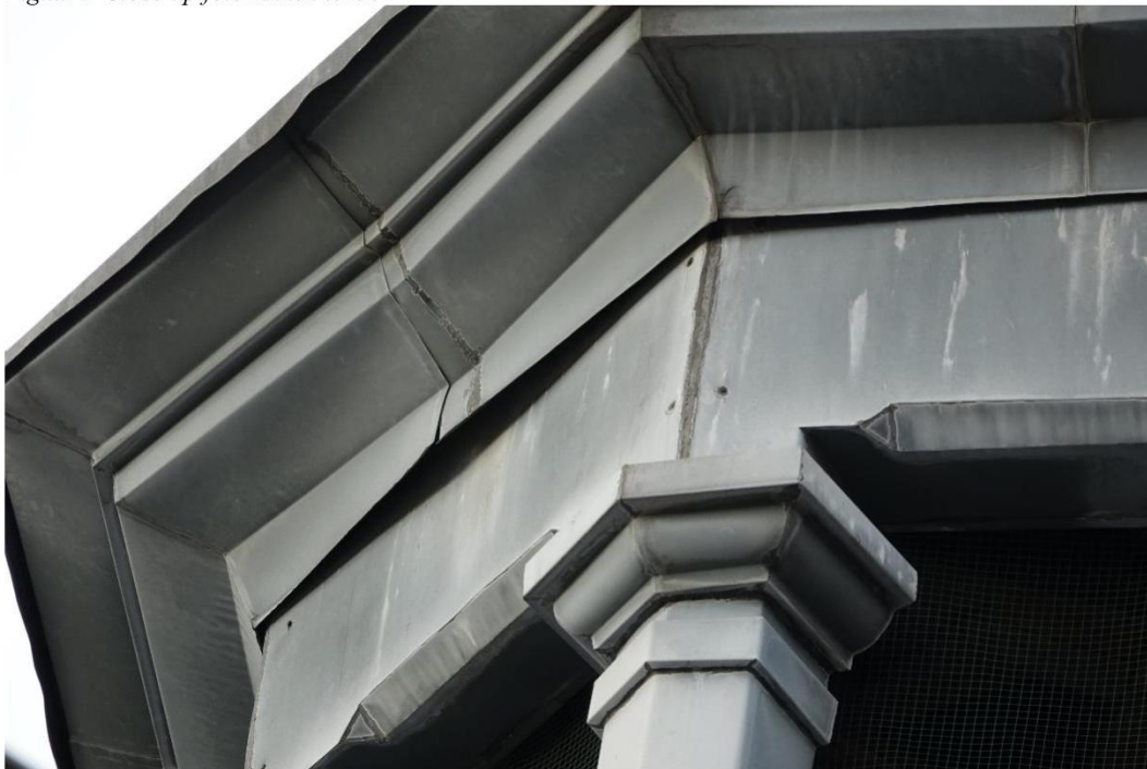
Figuur 5 Close-up foto zinken toren, loszittend zinkwerk
