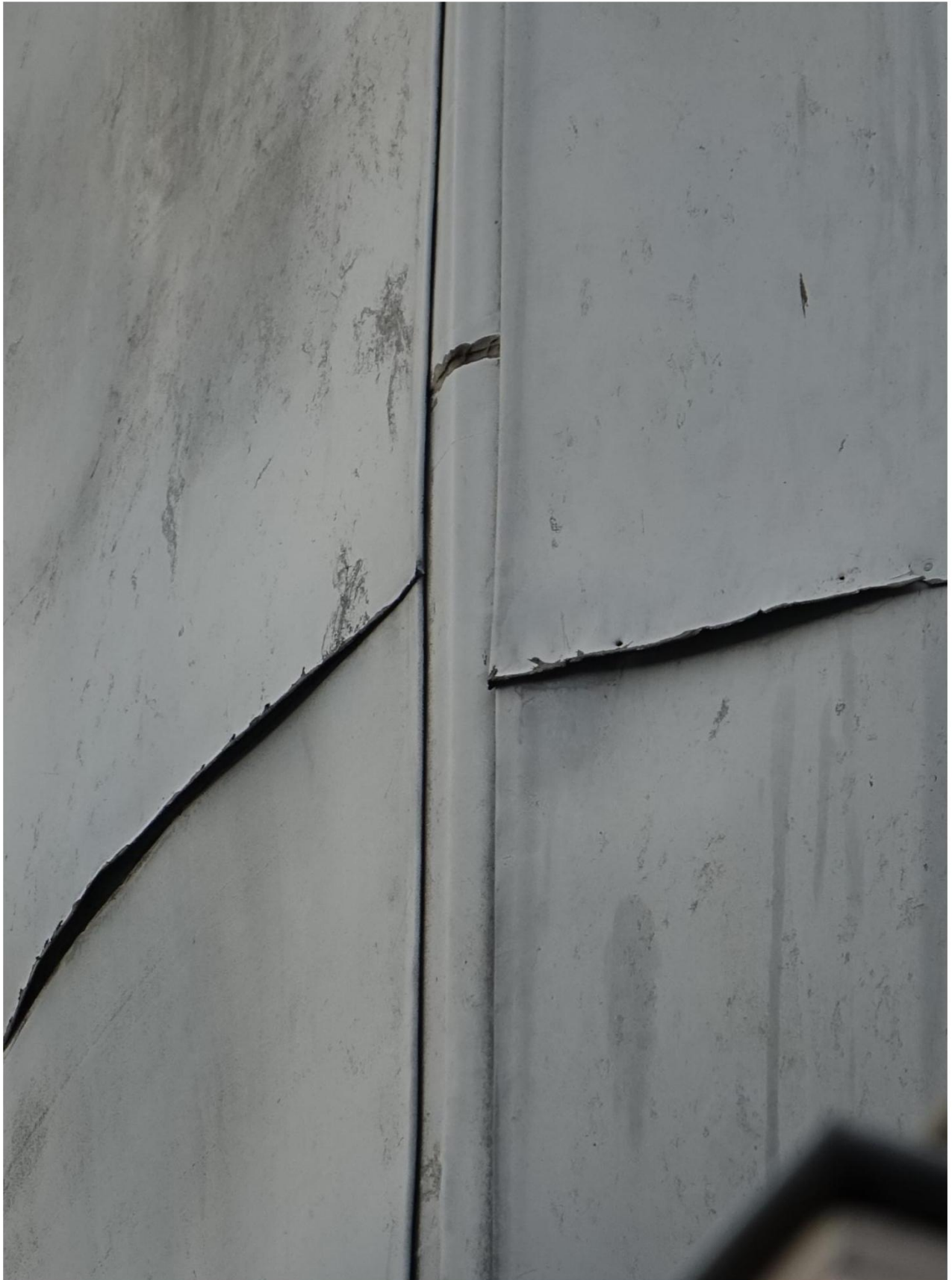
Figuur 6 Close-up foto zinken toren, loszittend zinkwerk
