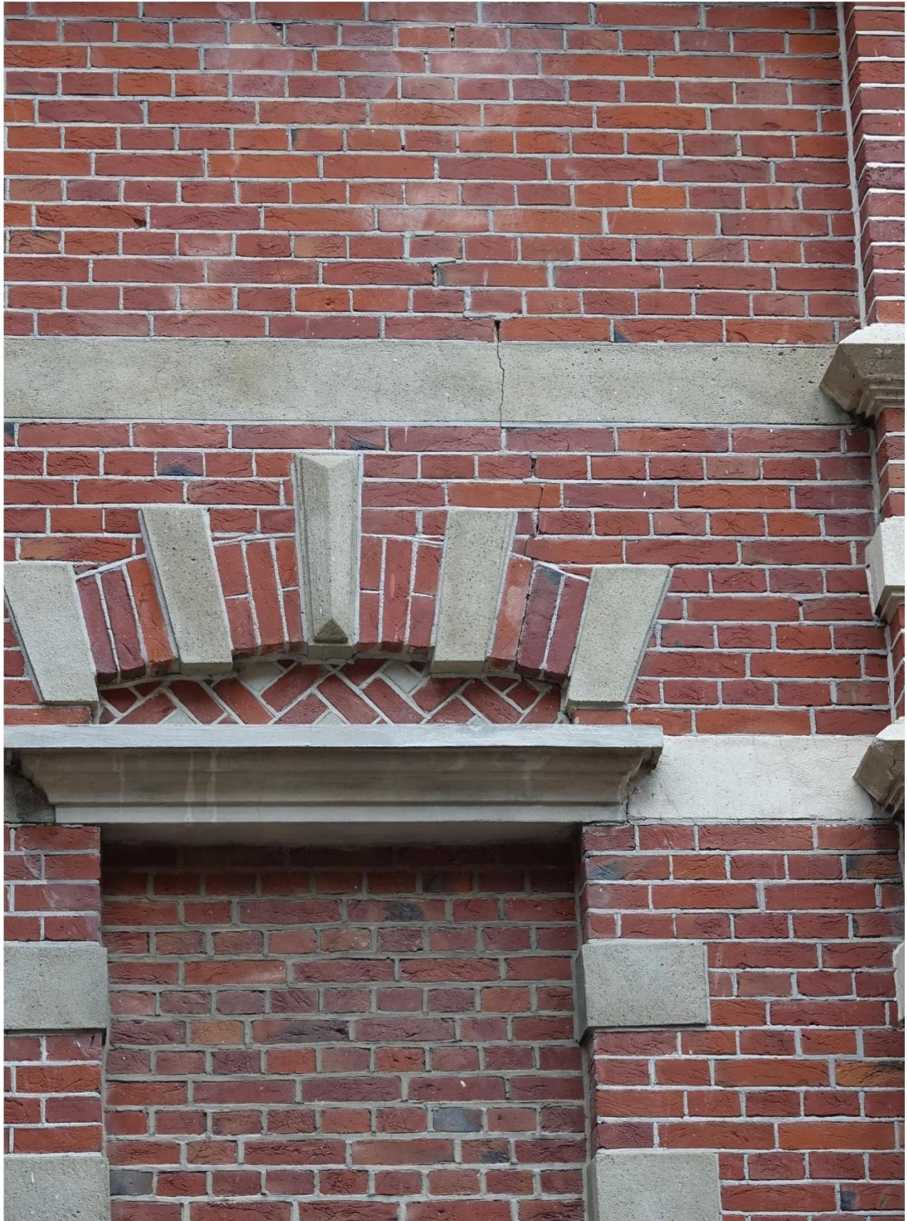
Figuur 18 Scheur in gevel
