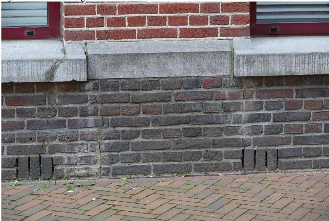
Figuur 12 Scheuren in plint
