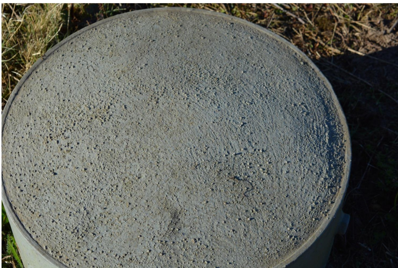
Figuur 3 Beton conditie
