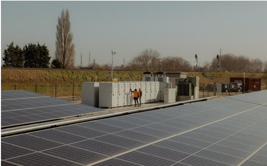
Figuur 3-4 Indicatief voorbeeld van batterijsysteem in containers bij een zonnenveld
