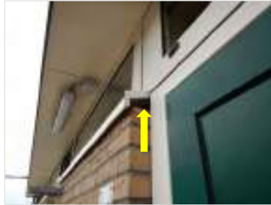
Figuur 4.12 Geschikte openingen die mogelijk naar de spouw leiden (A).
