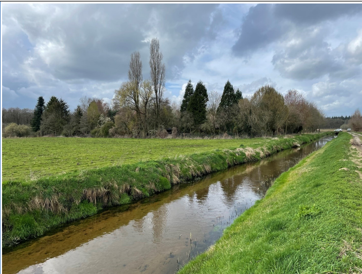
Afbeelding 13: Smakterveld, taludschade door uitspoeling en bevers (westelijk talud)
