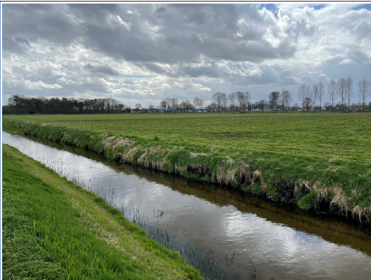
Afbeelding 12: Smakterveld, taludschade door uitspoeling en bevers (westelijk talud)
