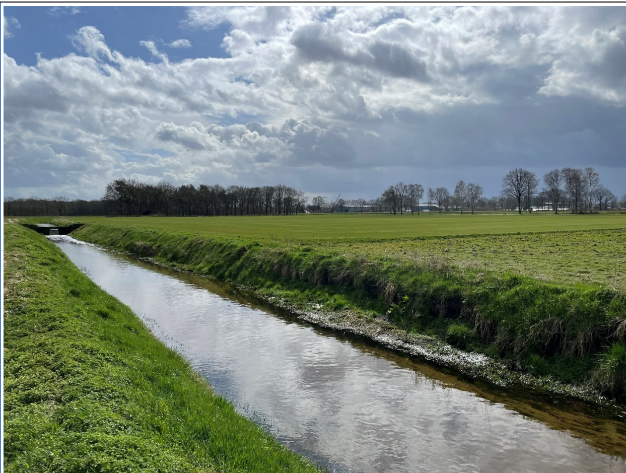
Afbeelding 15: Smakterveld, ingezakt talud.
