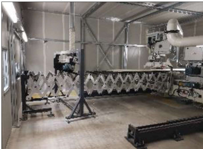
Afbeelding 2.4: foto binnenzijde geluidsisolerende cabine
