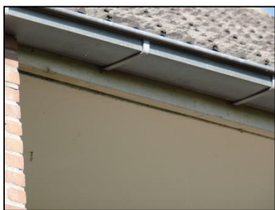
Figuur 14. Vooraanzicht van een woning. Er is ruimte aanwezig tussen houten planken.
