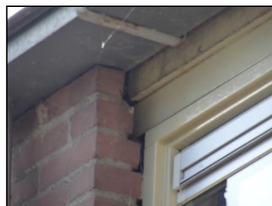
Figuur 9. Vooraanzicht van een woning. Er is ruimte aanwezig tussen de kozijnen en gevel (bakstenen).
