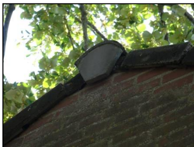
Figuur 2. Zij aanzicht van een woning. Er is ruimte aanwezig tussen het daknok en bakstenen. Bij sommigen woningen is de daknok gebroken en bij andere afwezig.
