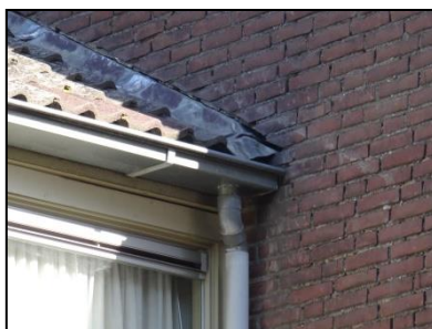
Figuur 8. Zij aanzicht van een van de woningen. De loodslabben langs de gevel zijn niet goed aangesloten.
