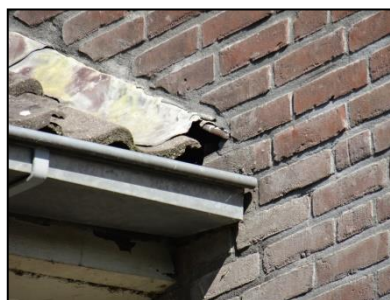
Figuur 15. Zijaanzicht van een van de woningen. De loodslabben langs de gevel zijn niet goed aangesloten.
