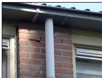
Figuur 12. Vooraanzicht van een de woning. Missende stukken cement geven (mogelijk) toegang tot de spouwmuur.
