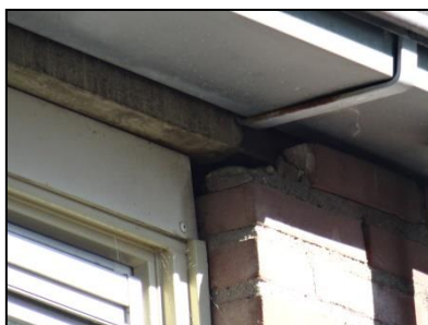
Figuur 11. Zijaanzicht van een woning. Het cement en delen bakstenen zijn missend.
