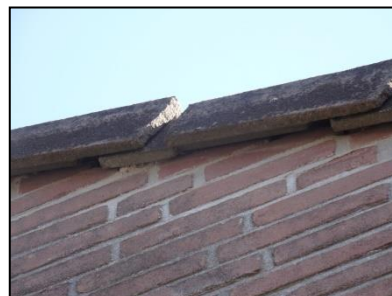
Figuur 3. Zij aanzicht van een woning. Het dak wordt begrensd door overhangende kantpannen met ruimte tot de gevel. Bij sommigen woningen zijn meerdere kantpannen gebroken en bij andere afwezig.
