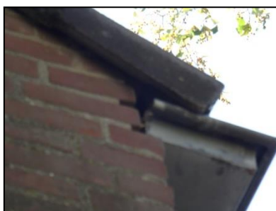
Figuur 5. Vooraanzicht van een woning. Op de hoek is ruimte aanwezig tussen de gevel, de dakpannen en de dakgoot.
