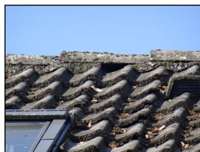
Figuur 6. Zicht op een dak. Bij de daknok zijn op meerdere locaties cement stukken afwezig.
