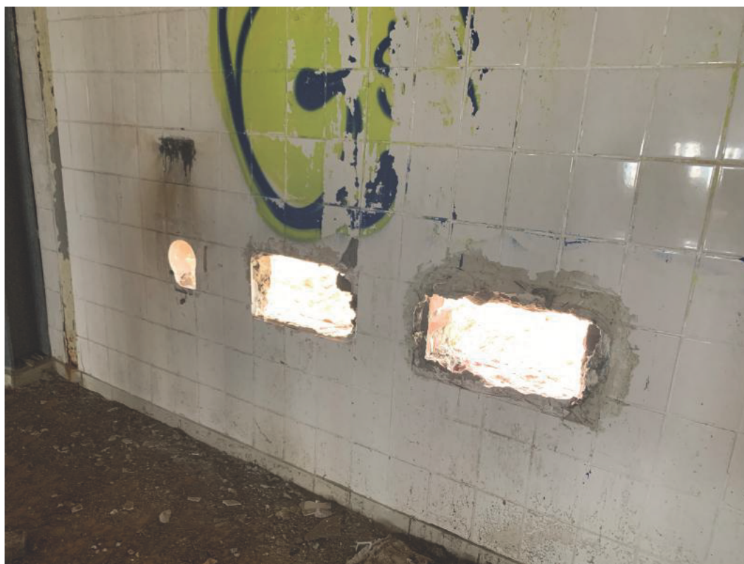
Foto 6 Gaten in de blinde westgevel van fase 2a, gezien van binnenuit (april 2023).
