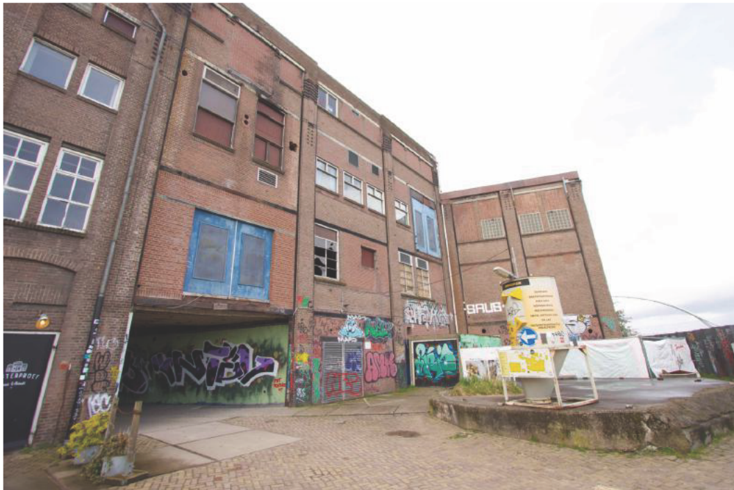
Figuur 12 De oostgevel van Latenstein waar het grenst aan fase 2b (april 2023). Vanaf boven de onderdoorgang staat fase 2b leeg en is bekeken tijdens de inspectie.
