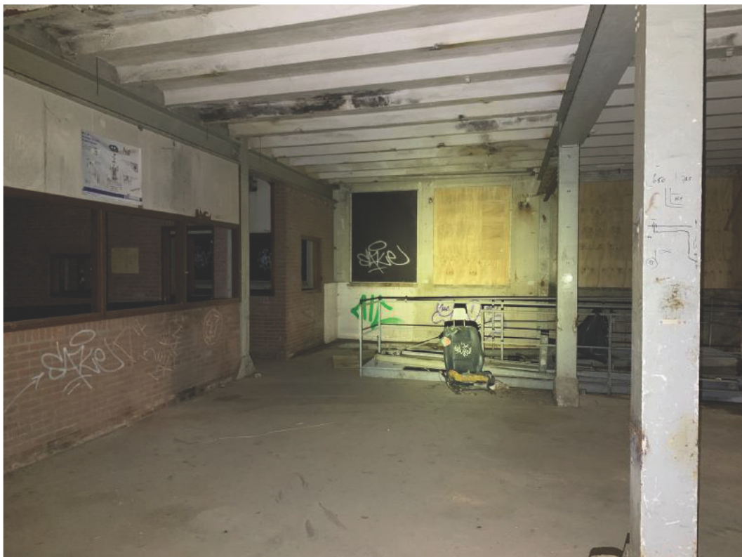
Figuur 14 Op enkele plaatsen zijn door krakers spullen gedumpt.
