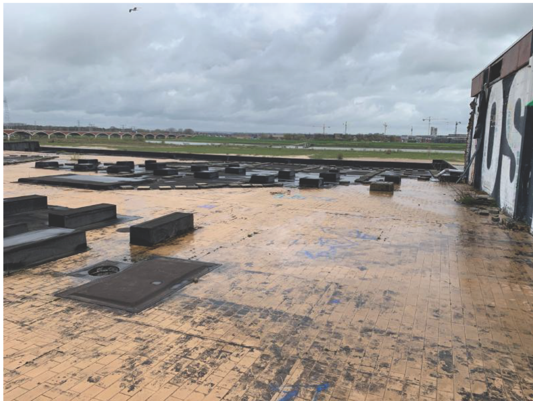
Foto 5 Het platte dak van Latenstein (fase 2a), met name aan de Waalzijde verzwaard met tegels vanwege de slechte staat van de dakbedekking.
