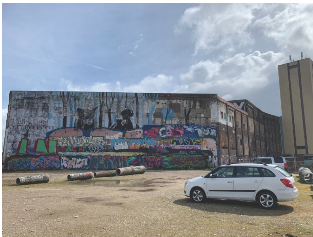
Foto 4 Blinde westgevel en zuidgevel van Latenstein (fase 2a) (april 2023). Potenties voor verblijfplaatsen van vleermuizen zijn te vinden in scheuren en missende specie in de gevels.
