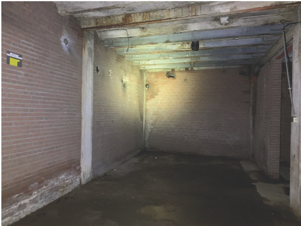
Figuur 15 Begane grond in fase 2a met natte vloeren op de plaats van lekkages.
