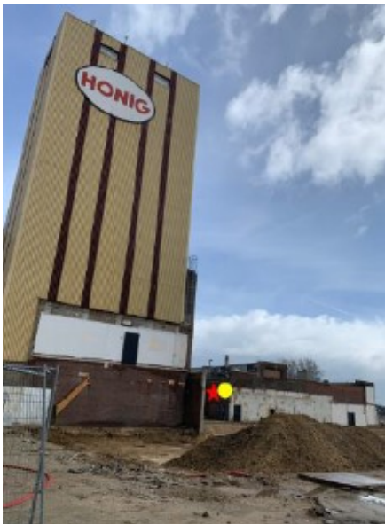
Figuur 3: Indien de twee tijdelijke kasten op deze foto niet buiten invloed van de werkzaamheden hangen, dienen deze kasten verplaatst te worden (zie voorschrift 25).
