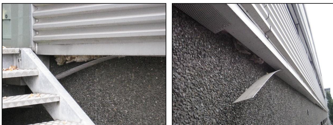
Figuur 10. Loshangend isolatiemateriaal en afschermrooster aan de zuidkant van gebouw H31 (augustus 2018).
