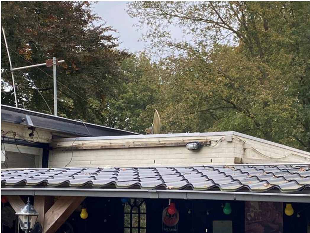
Gebouw A open stootvoegen -18 - 07-11-2024 13:41
