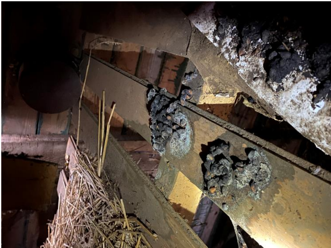
Gebouw B latrine naast stro -8 - 07-11-2024 13:39
