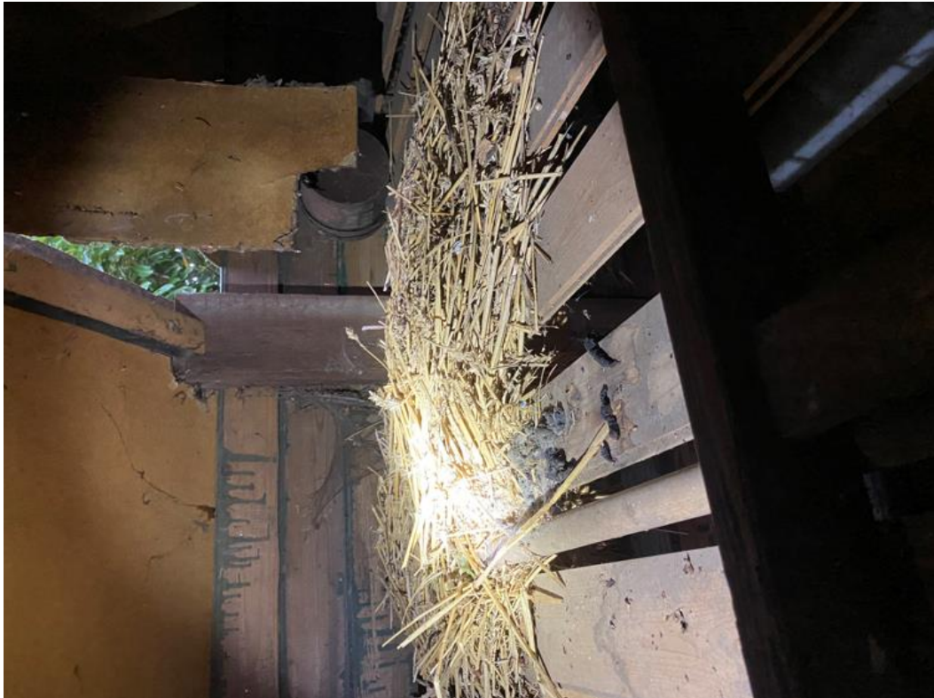
Gebouw B stro op zolder en uitwerpselen van marter -12 - 07-11-2024 13:40
