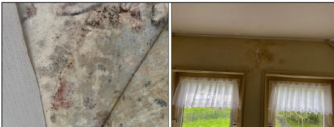
Figuur 4.1 Schimmelvorming en vochtophoping in de woning aan de Bonegraafseweg 3 te Ochten. Schimmel en vocht is aanwezig in de kozijnen, vloer en muren en onder het dak. Schimmels en vocht hebben de woning dermate aangetast dat sloop en nieuwbouw de enige optie is vanuit het belang Volksgezondheid. Zie overige foto's in Bijlage 1.
