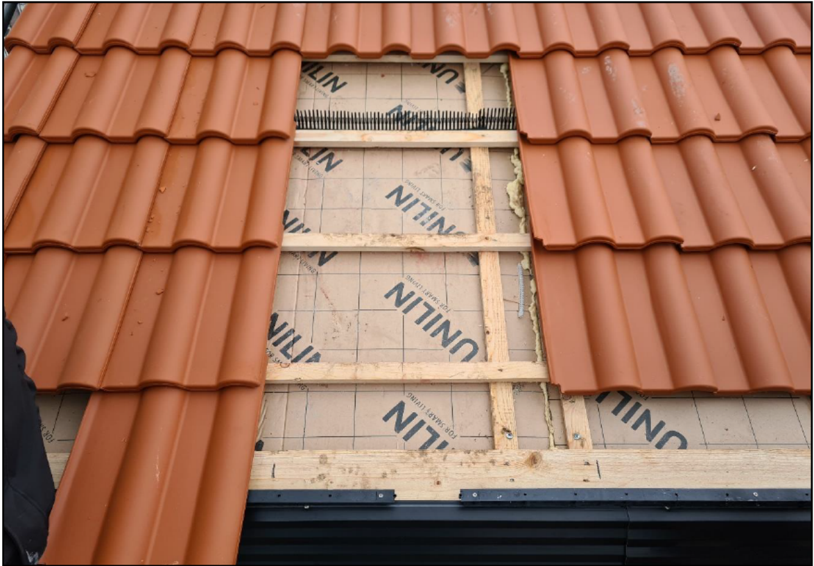
Figuur 2.1 Het plaatsen van vogelschroot op de 4 e panlat waarborgt dat de drie onderste rijen dakpannen toegankelijk wordt gehouden voor huismussen.
