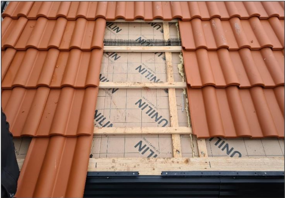
Figuur 2 Het plaatsen van vogelschroot op de 4e panlat waarborgt dat de drie onderste rijen dakpannen toegankelijk wordt gehouden voor huismussen.
