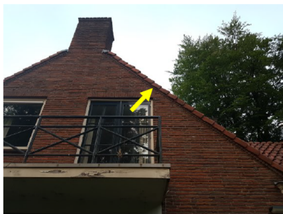
Figuur 5. Zomerverblijfplaats van een gewone dwergvleermuis onder een kantpan aan de achterzijde van het woonhuis (gele pijl).
