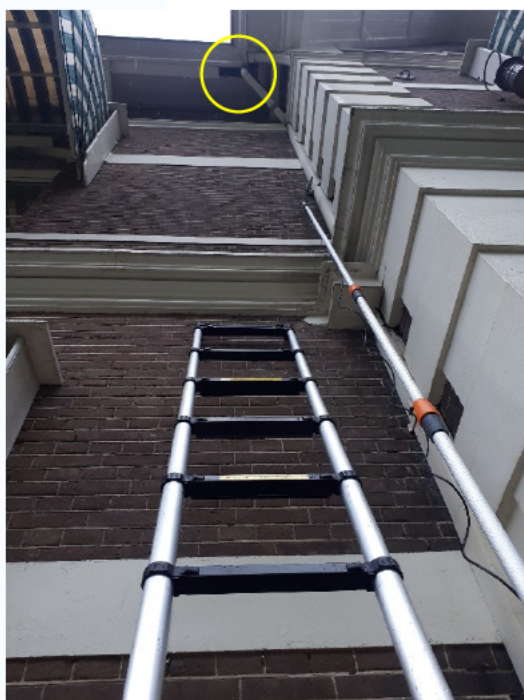
Figuur 6. Voorbeeld van één van de drie openingen aan de buitenkant van de boeiboorden van Stationsweg 8.
