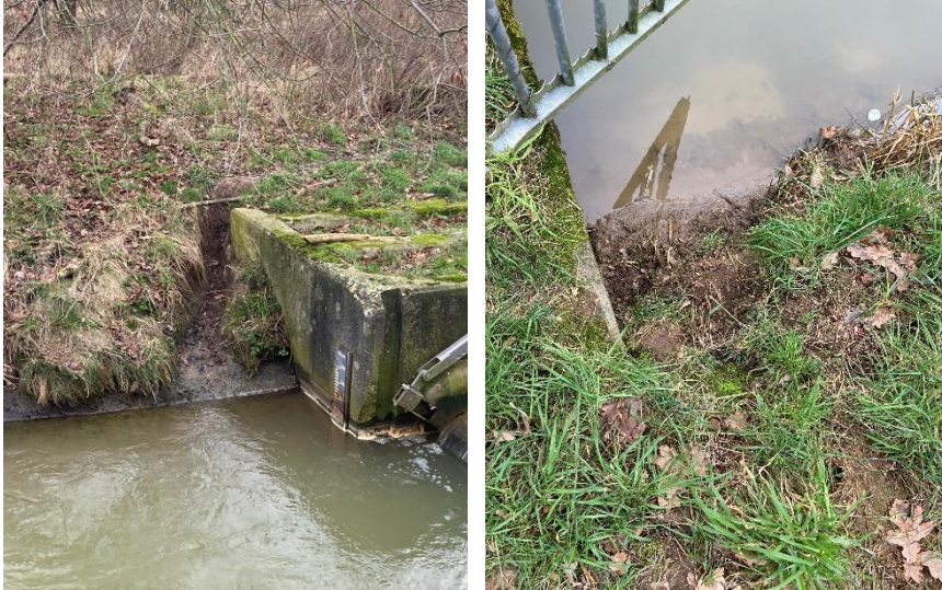
Afbeelding 8. Uittredeplaatsen van muskusrat langs de stuw bij RWZI Dreumel. Opname: 12 januari 2024.
