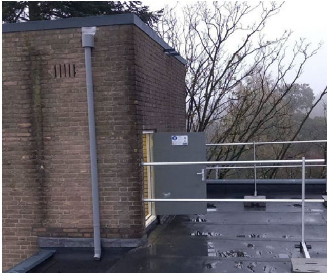
Figuur 1. Aanwezige open stootvoegen liftschacht.
