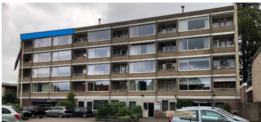
Figuur 4: Foto van de westgevel van de flat met het massawinterverblijfplaats aangegeven met blauw. Dit stuk spouw wordt afgesloten met spouwborstels zodat het isolatiemateriaal tegen worden gehouden.
