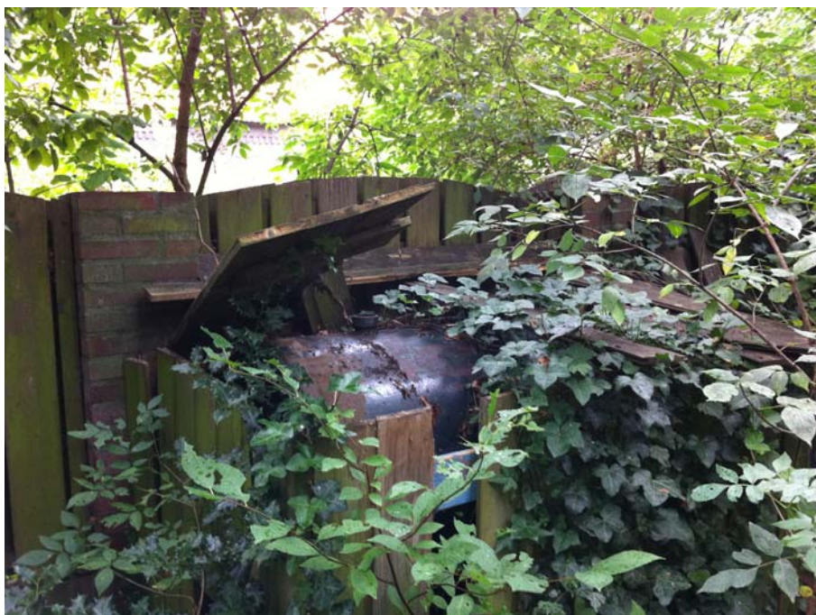
Foto bovengrondse brandstoftank achterzijde woning.
