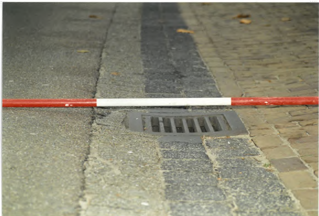
Foto 12. Detail verschil hoogteligging rijbaan - opstelstrook tankstation.
