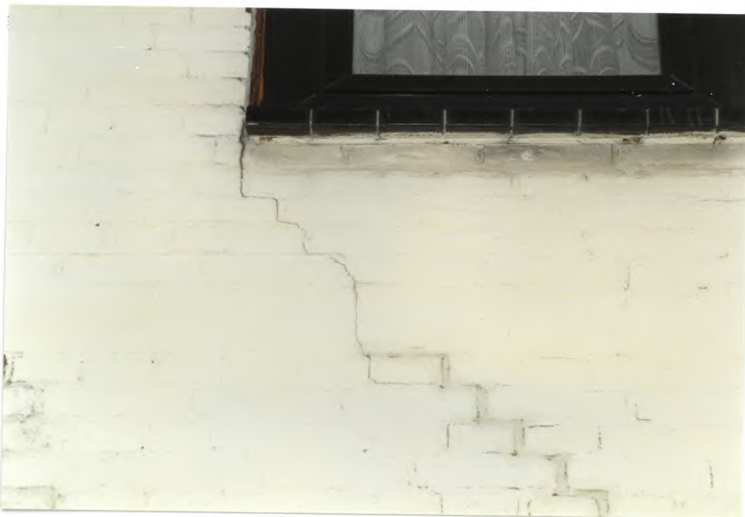
Foto 19. Scheurvorming in pand 241.
