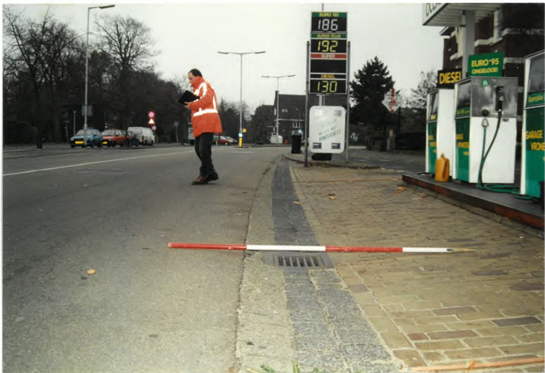
Foto 11. Verschil hoogteligging rijbaan - opstelstrook tankstation.
