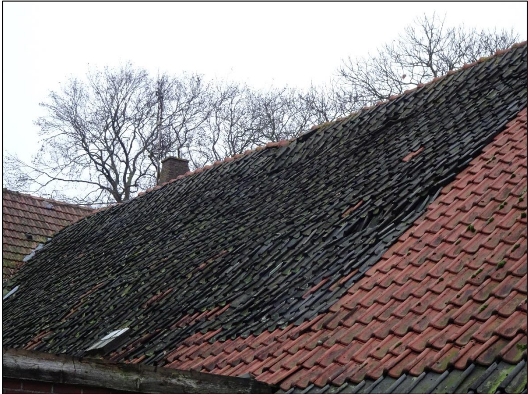
Scheefliggende dakpannen op het dak van het woonhuis.
