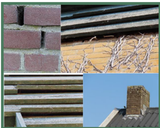
Foto 1: Spouwvoegen, ruimte onder dakpannen en open plekken in de houten muurbewerking Bron: Quickscan BNL Advies d.d. 15 augustus 2024
