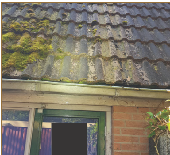
Afbeelding 2.18: Onder de dakpannen van het gebouw in deelgebied C.
