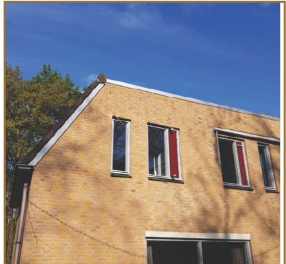
Afbeelding 2.17: Open stootvoegen in de bebouwing van deelgebied C.
