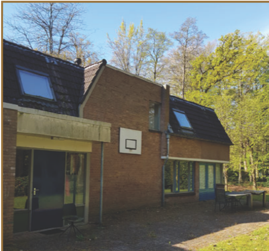
Afbeelding 2.10: Open stootvoegen in de bebouwing van deelgebied B.
