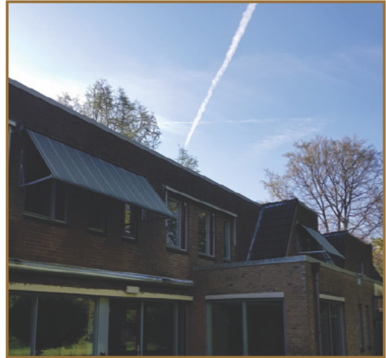
Afbeelding 2.15: Open stootvoegen in de bebouwing van deelgebied C.
