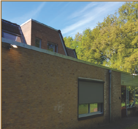
Afbeelding 2.16: Open stootvoegen in de bebouwing van deelgebied C.
