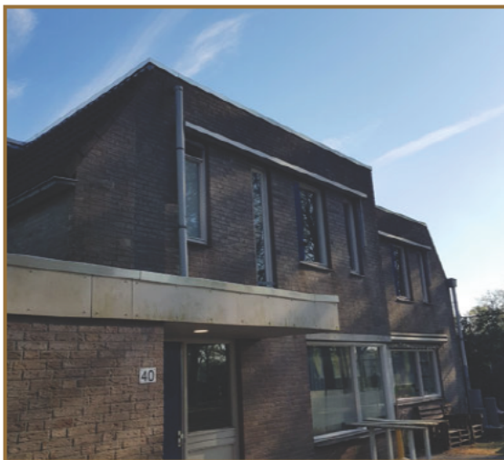
Afbeelding 2.24: Open stootvoegen in de bebouwing van deelgebied D.
