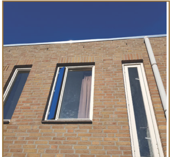
Afbeelding 2.23: Open stootvoegen in de bebouwing van deelgebied D.
