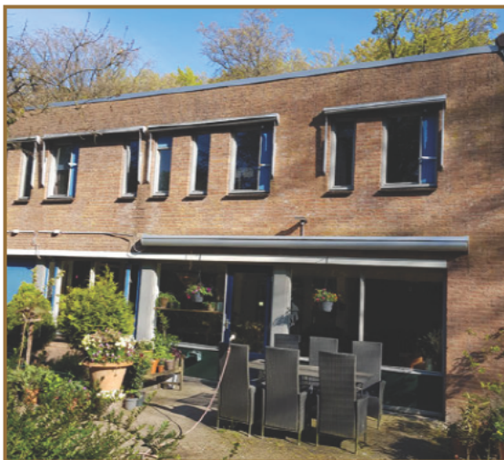
Afbeelding 2.12: Open stootvoegen in de bebouwing van deelgebied B.
