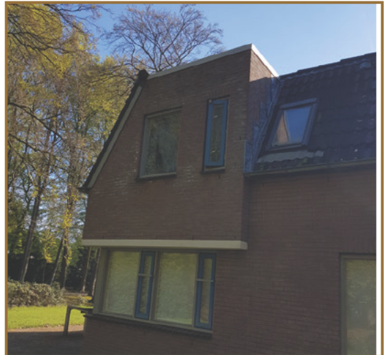
Afbeelding 2.11: Open stootvoegen in de bebouwing van deelgebied B.
