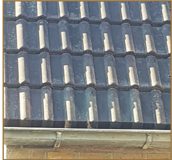
Afbeelding 2.21: Er is geen ruimte onder de dakpannen in deelgebied D.
