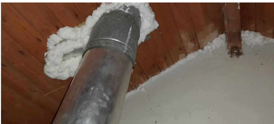
Afbeelding 5: De zolder met daarop een voorbeeld van de recent afgedichte kieren. Gebouw 2
