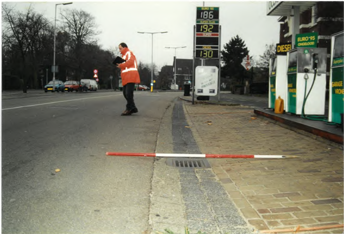
Foto 11. Verschil hoogteligging rijbaan - opstelstrook tankstation.
