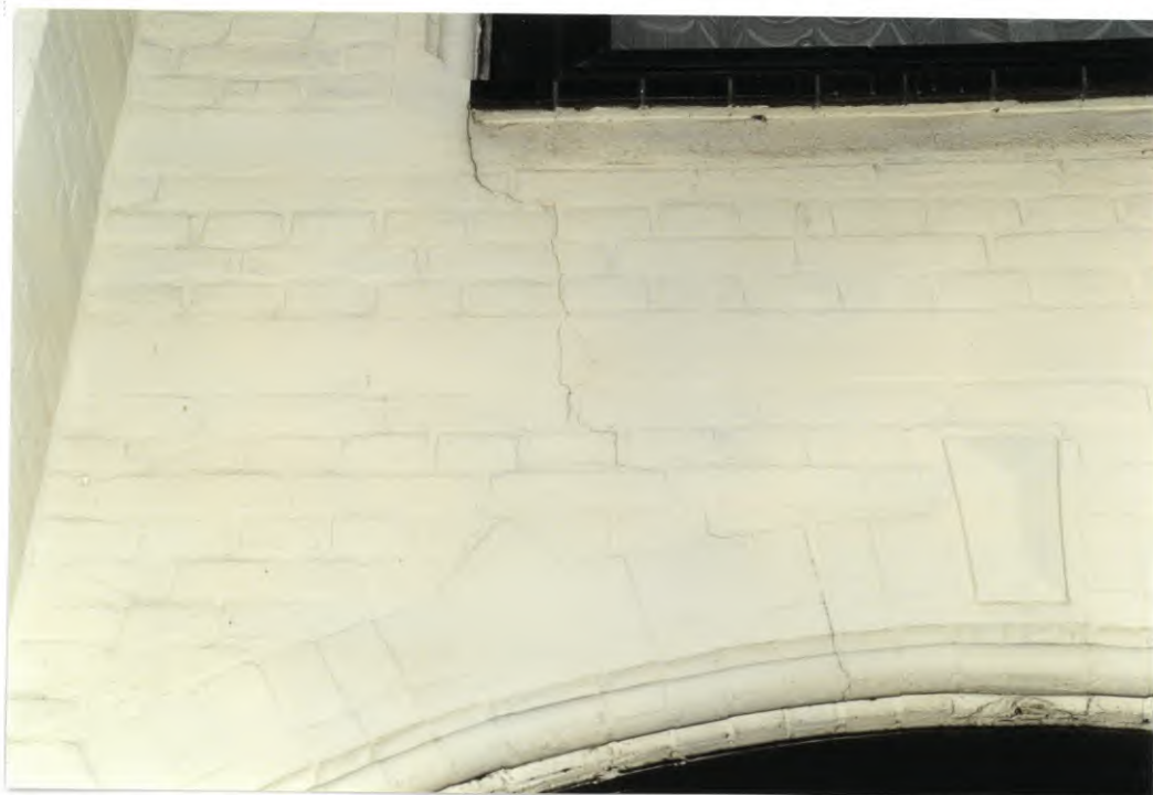
Foto 20. Scheurvorming in pand 241.
